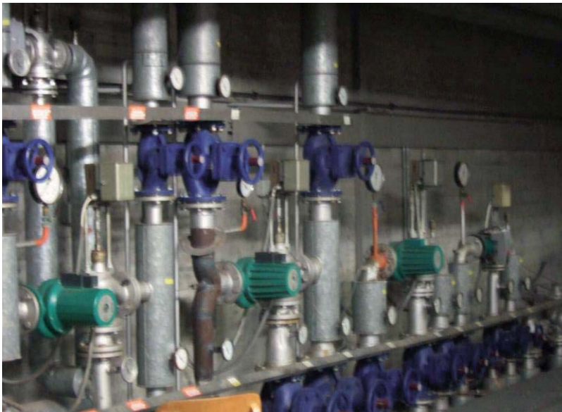
Abbildung 5-3 Schwachstelle nicht vollständig gedämmte Wärmeverteilungsleitungen
